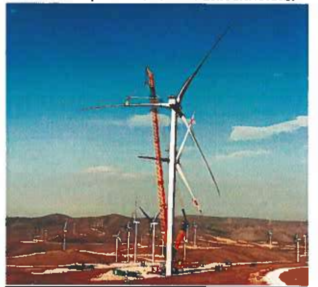
BAĞLAR RÜZGAR ENERJİ SANTRALİ PROJESİ
