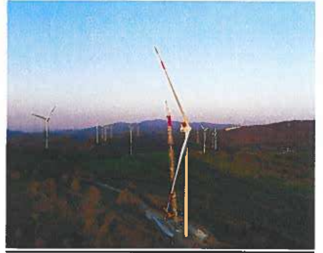
BALIKESİR ŞANLI RÜZGAR ENERJİ SANTRALİ
